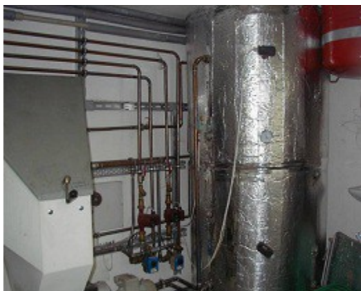
Zapojení kotle BENEKOV ling 25 Instalovaný kotel: BENEKOV ling 25 Preferované palivo: hnědé uhlí ořech 2 Rodinný dům Lokalita: Náchodsko
